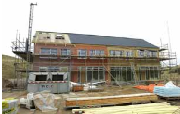
Figuur 4-1: Constructie van vier “eengezinswoningen” op het laboratoriumterrein van het ECN (juni 2000, digitaal archief ECN).
